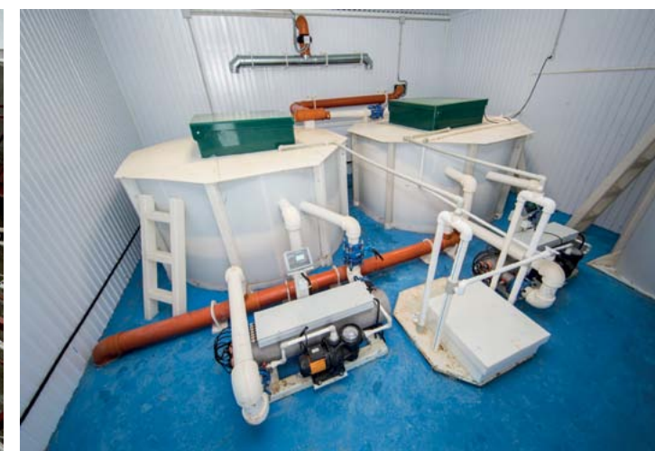
Цех доочистки и обеззараживания "ЕВРОБИОН-ГРАНД"
