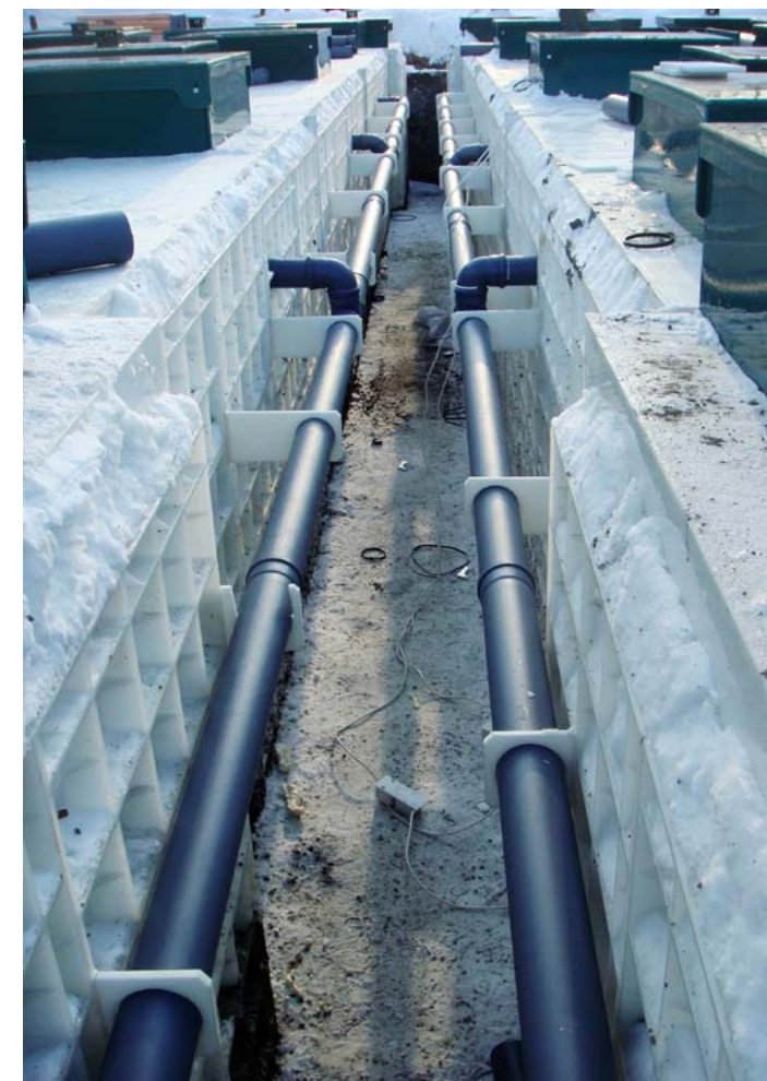
Обвязка смонтированных модулей станции "ЕВРОБИОН-БИОМАТРИКС"
